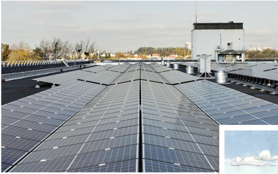
Autoconsommation photovoltaïque Arcanson
