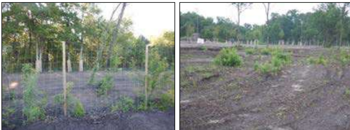
Figure 46 : Développement d'espèces invasives sur chantier après travaux de terrassement (Source : ENVOLIS)
