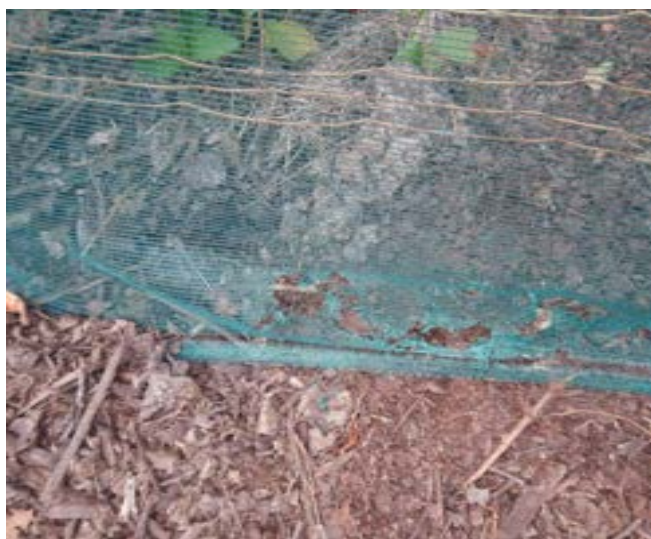
Figure 42 : Exemple de barrière insuffisamment enterrée et matériau peu solide (Source ENVOLIS)
